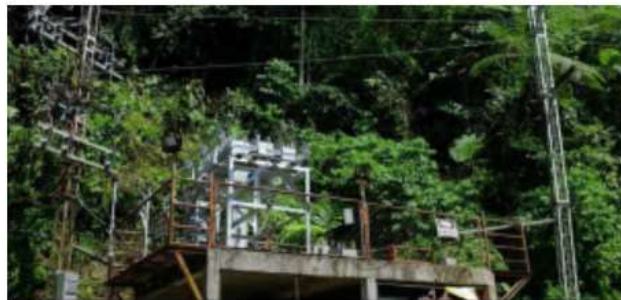
APEX - Maligaya (2400 KVAR, 4.16KV APEX -Fam shaft (1052 KVAR, 4.16KV) Lamsan, Inc.
